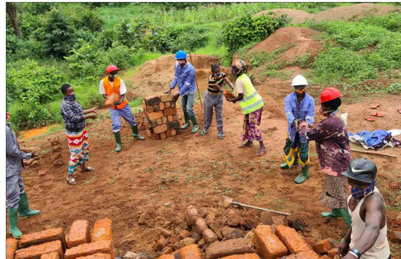
▲ Site de production et de vente de briques de terres cuites de l'Association « Tena De Tena » à Bria
