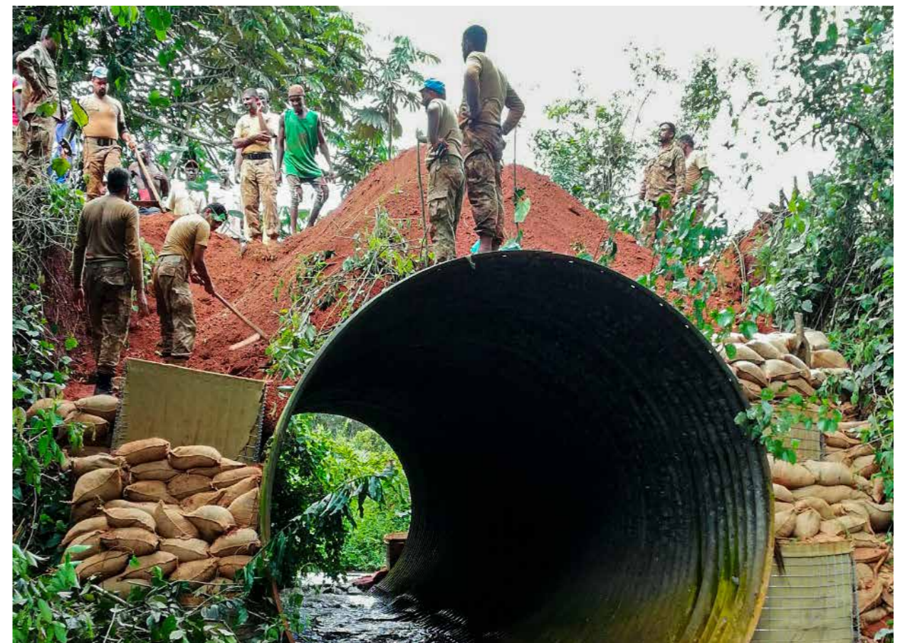
▪ Pont en cours de réhabilitation par le contingent pakistanais de la MINUSCA / MINUSCA - Aleka Amuri
