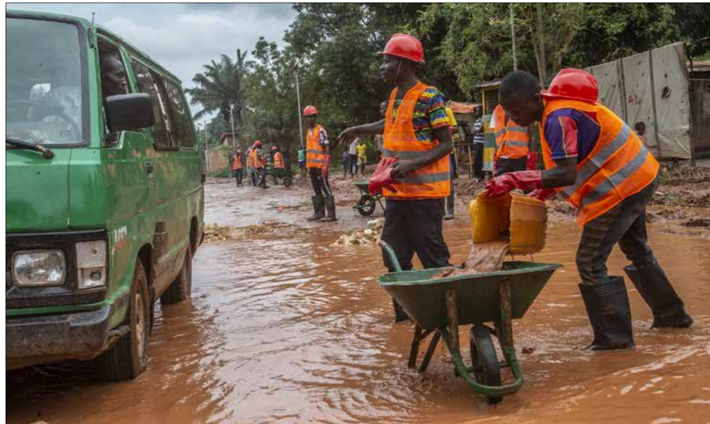
Remblayage des trous sur l'axe dégradé sur la route Bangui-Damala, dans le 8e arrondissement de Bangui, organisé dans le cadre de la campagne de la sécurité routière que soutient la MINUSCA.
